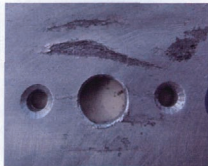
图1 未喷丸表面腐蚀形貌
